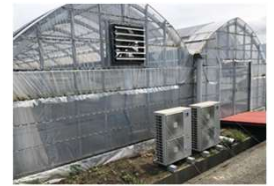
ヒートポンプ(室外機)
