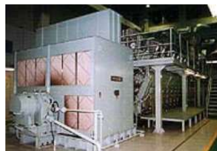
内燃力発電プラント
