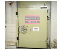
漏水対策(水密扉)
