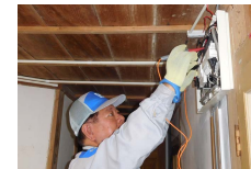
屋内配線診断（熊本配電事業所）
