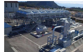
山川バイナリー発電所
