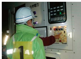
高圧発電機車による電源供給(夜間)
