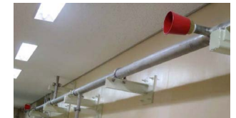
自動消火設備(ハロン消火設備)
