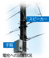
電柱への設置状況
