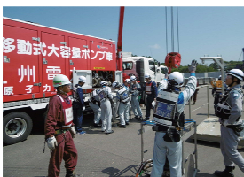
移動式大容量ポンプ車の設置
