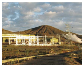
オルカリアV地熱発電所(ケニア)
