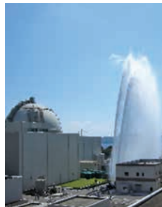
放水砲による放水
