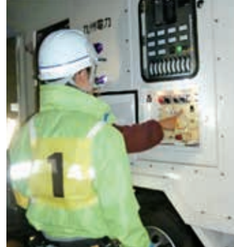
高圧発電機車による電源供給 (夜間)
