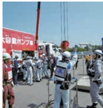
移動式大容量ポンプ車の設置
