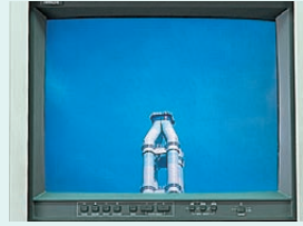
排煙監視テレビ
