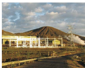
オルカリアV地熱発電所(ケニア)
