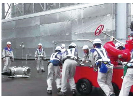
放水砲の設置
