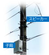
電柱への設置状況
