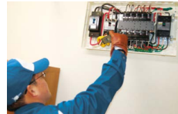
分電盤の点検
