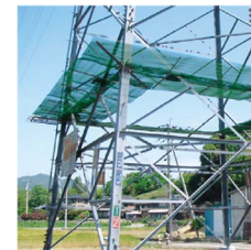
送電鉄塔の昇塔防止装置の設置
