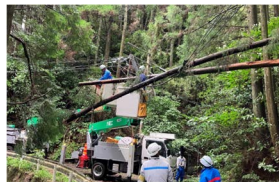
倒木による設備被害箇所の復旧状況
