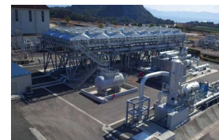
山川バイナリー発電所
