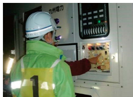
高圧発電機車による電源供給(夜間)
