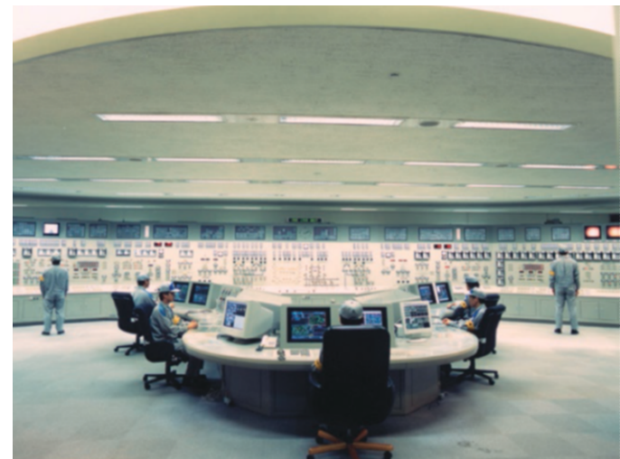
▼ 火力発電所における常時監視体制の様子
