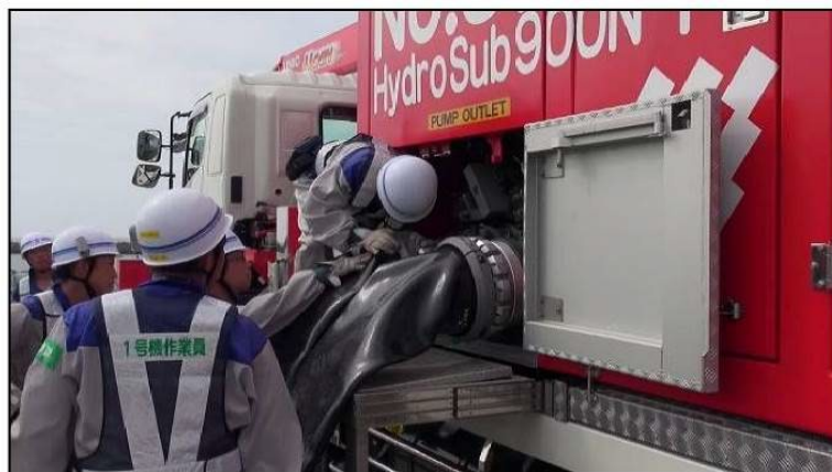
移動式大容量ポンプ車の設置
