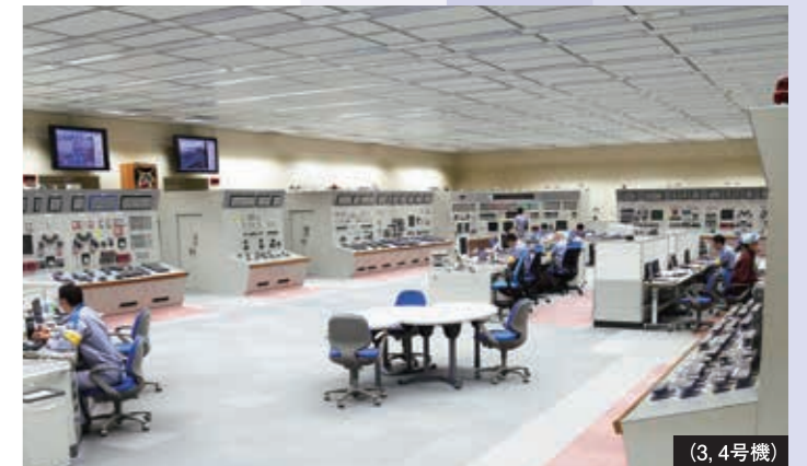
中央制御室 中央制御室はさまざまな計器、警報装置や監視装置、操作スイッチ等があり発電所の頭脳にあたる場所です。運転員は、24時間体制で原子炉やタービン、発電機などの監視にあたっています。 (3, 4号機)
