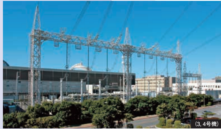
変圧器・屋外開閉所 発電機で発生した電気は変圧器で電圧を上げ送電線で各地へ送られます。開閉所は、発電所と送電線をつなぐスイッチの役目をするところです。 (3, 4号機)
