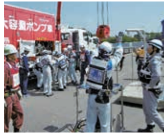
移動式大容量ポンプ車の設置
