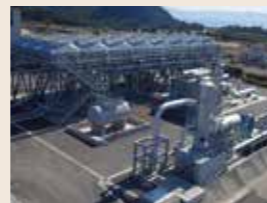
山川バイナリー発電所
