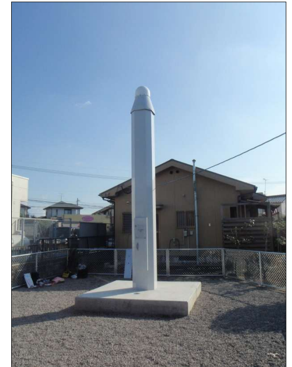
吉野町の機器設置状況
