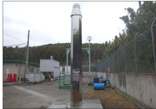
竹島の機器設置状況
