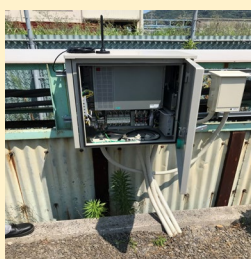
【検出装置の設置状況】
