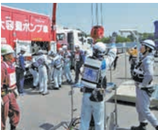
移動式大容量ポンプ車の設置
