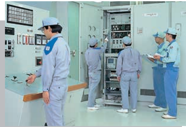
制御棒制御装置
