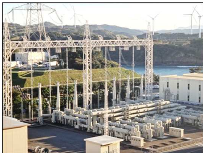
図1 特高開閉所外観
