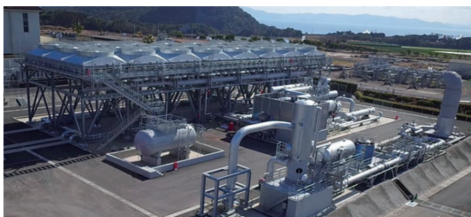
未利用エネルギーを活用した山川バイナリー発電所
