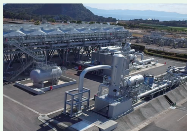
山川バイナリー発電所 [鹿児島県]
