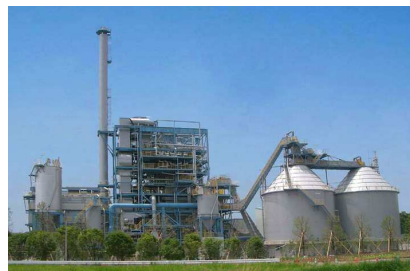
新工場発電事業 (みやざきバイオマス燃料株)
