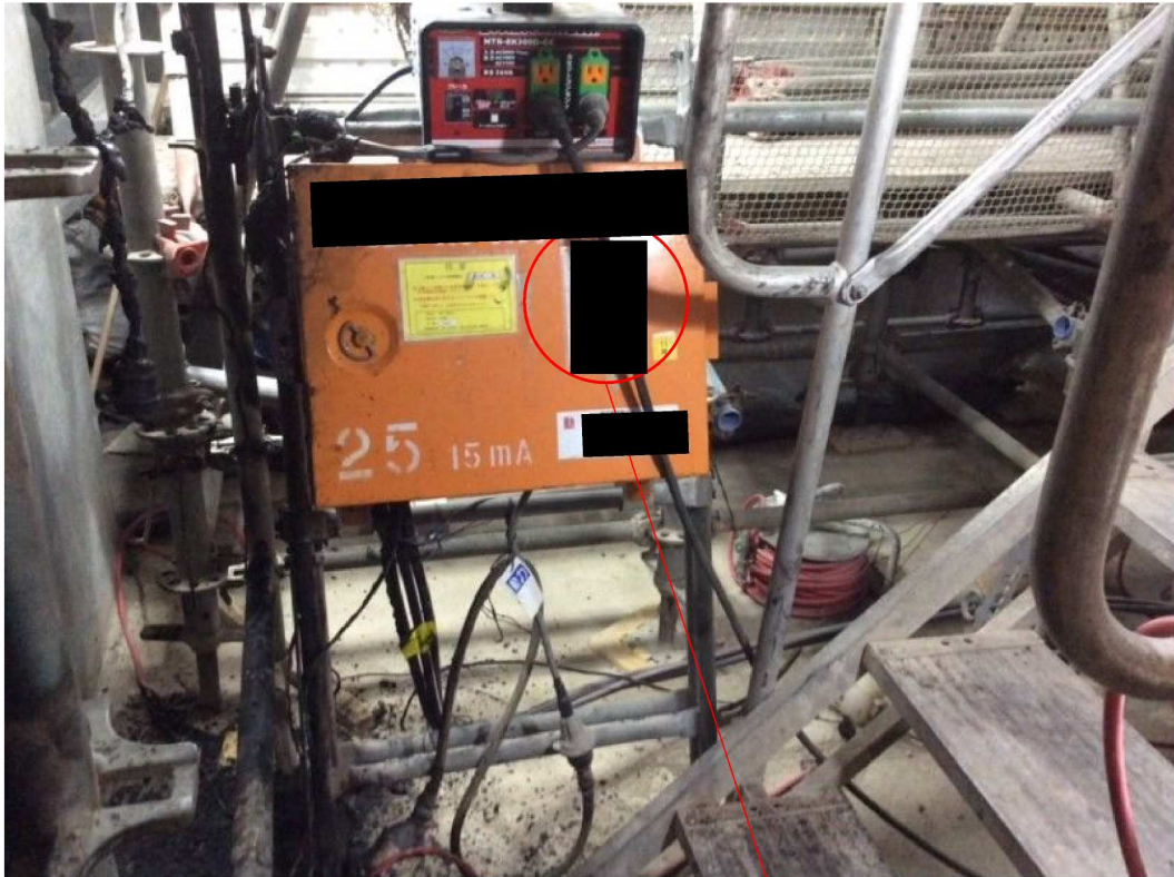
仮設電源盤・降圧トランス (遠景)
