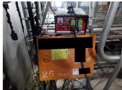
仮設電源盤・降压トランス
