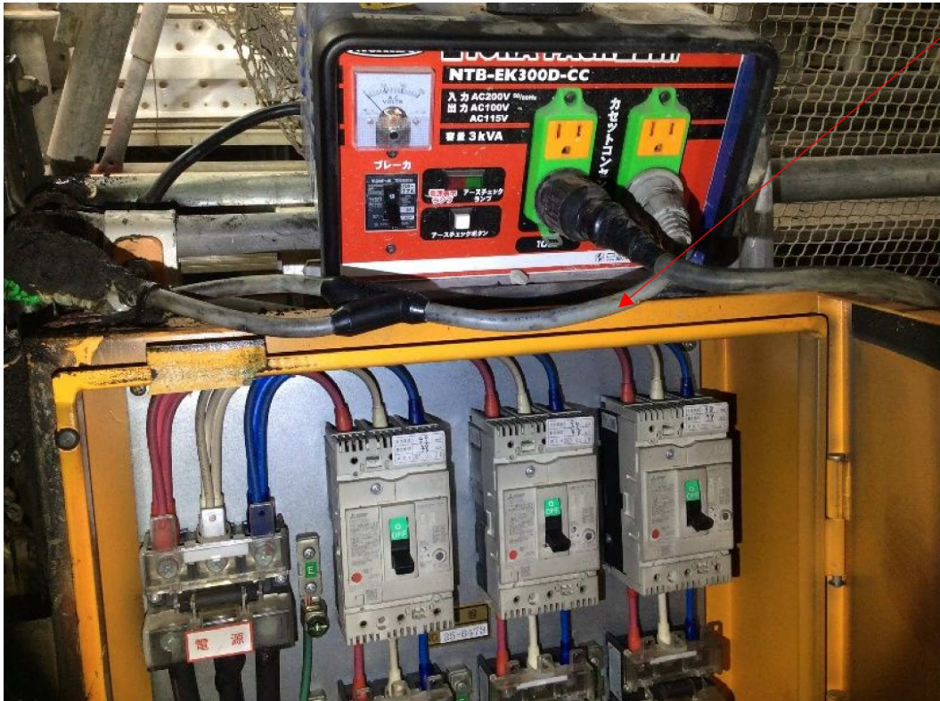
仮設電源盤・降圧トランス (近景)
