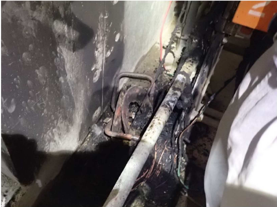
焼損した電工ドラム、半断線したケーブルA
