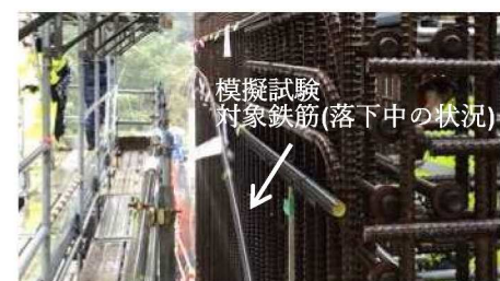
段取筋フックから落下させた後の状態 （全ての結束線が断線し、落下）
