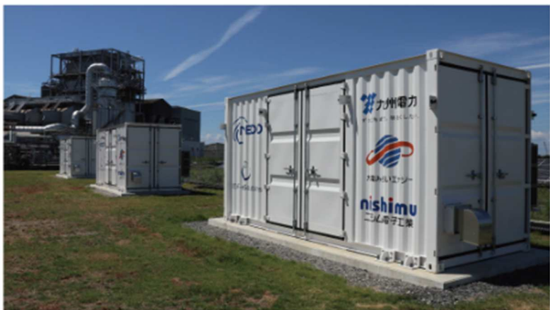
大牟田蓄電所の外観 (出力1,000kW、蓄電容量3,000kWh)
