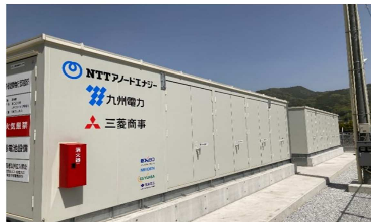
福岡県田川郡に設置した蓄電システム
