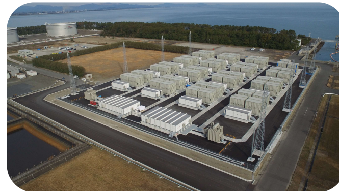
▼ 豊前蓄電池変電所全景
