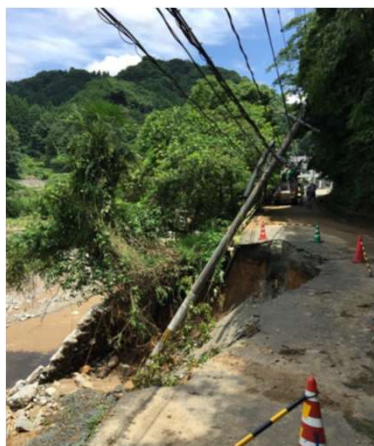
[道路決壊による電柱倒壊状況]
