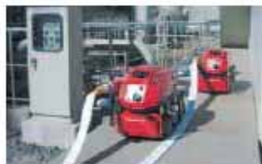
① 仮設ポンプ
