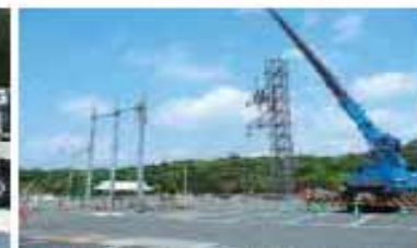
⑤ 早期電源復旧対策訓練
