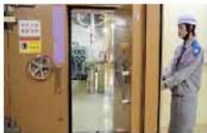
②タービン動補助 給水ポンプ室の水密扉
