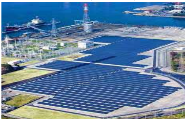
【メガソーラー大牟田発電所】
