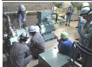
常設電動注入ポンプ点検
