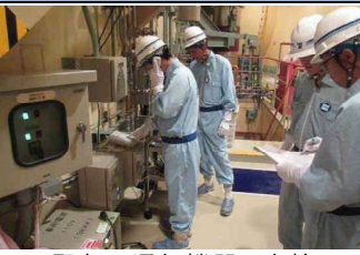
緊急用通信機器の点検
